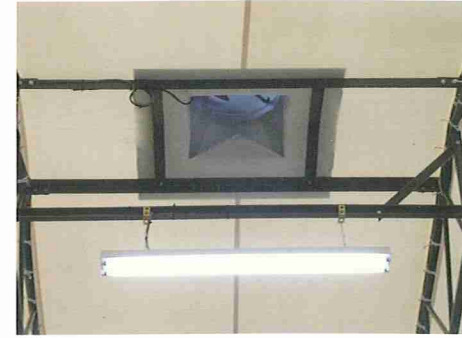
天井換気ファン
